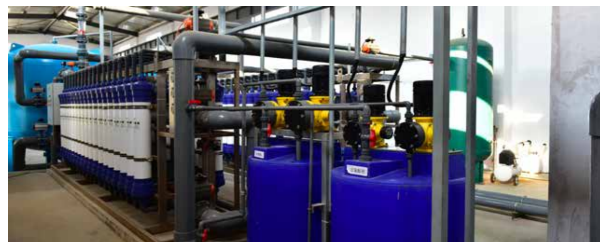
焦家金矿中水处理设施
